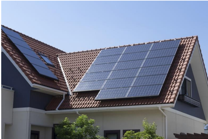
Panneaux photovoltaïques sur maison individuelle
