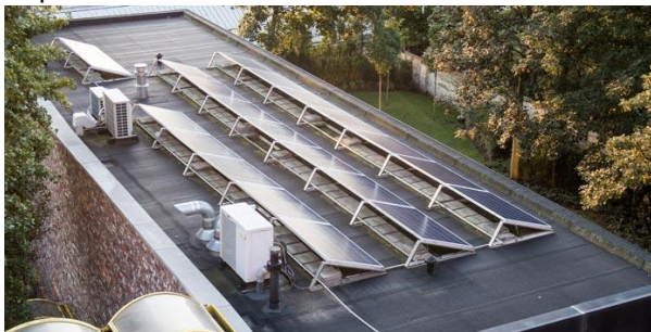
Panneaux photovoltaïques sur toit terrasse
